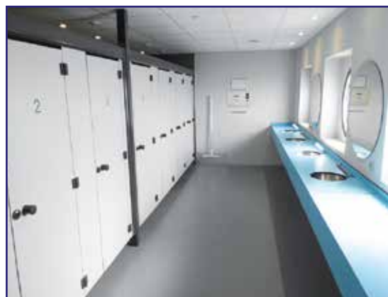
Sanitair blok Bloc sanitaire Sanitary block
